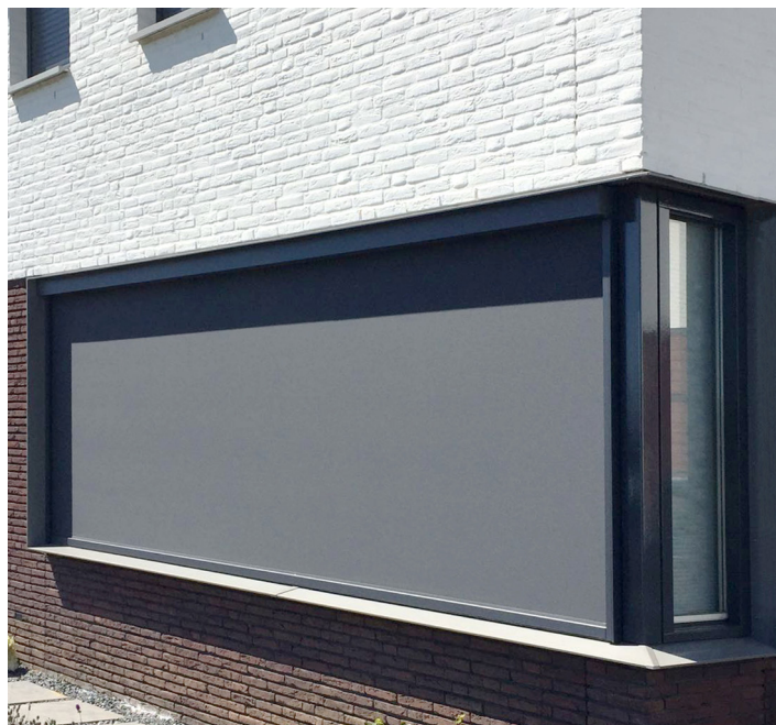
montiert am Fenster
